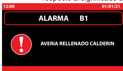
Ejemplo de ventana de alarma.
